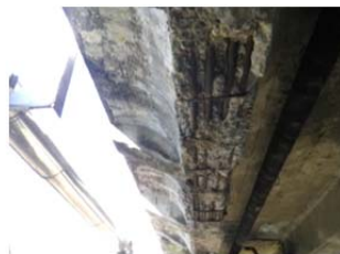
鉄筋の腐食によりコンクリートが剥落
