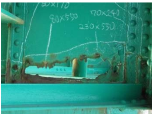
網部材で腐食が進展
