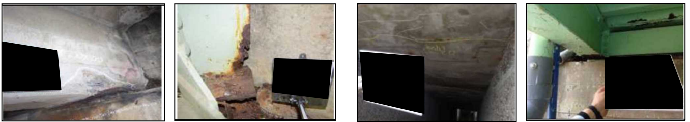
A橋の損傷例 (劣化速度：大) B橋の損傷例 (劣化速度：大) L橋の損傷例 (劣化速度：中) M橋の損傷例 (劣化速度：中)
